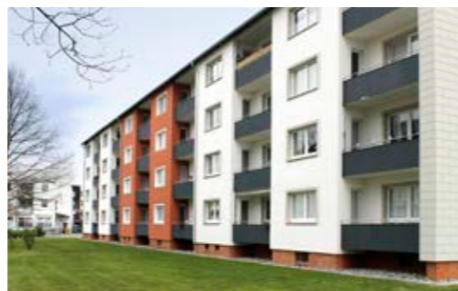
An den Häusern im Wildkamp in Salzgitter wurde die Dämmung ausgebessert und die Ziegel der Dächer wurden ausgetauscht.
